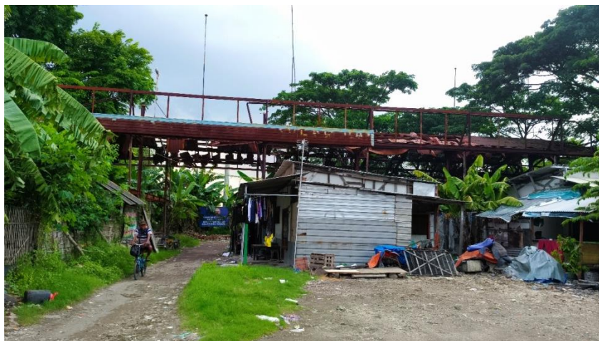
Gambar 1. Struktur bangunan yang mengalami korosi (Sumber: Dokumentasi penulis, 2026)
